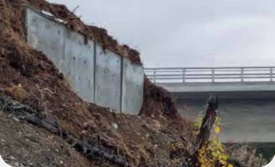
Sandsvalehotell konstruert ved bruk av betongblokker, før vegetasjonen har grodd til. Foto Dag Aakre.
